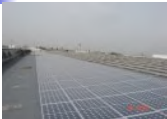
地上の太陽光発電所(ドイツ5MW)
