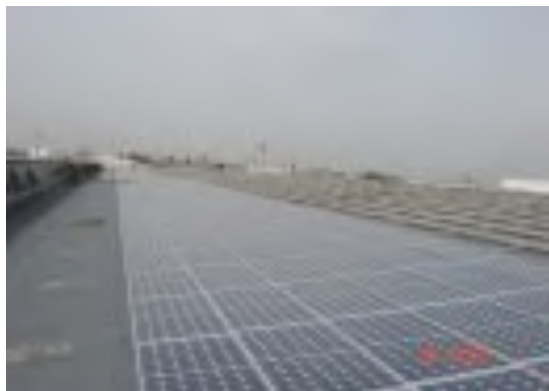
地上の太陽光発電所(ドイツ5MW)
