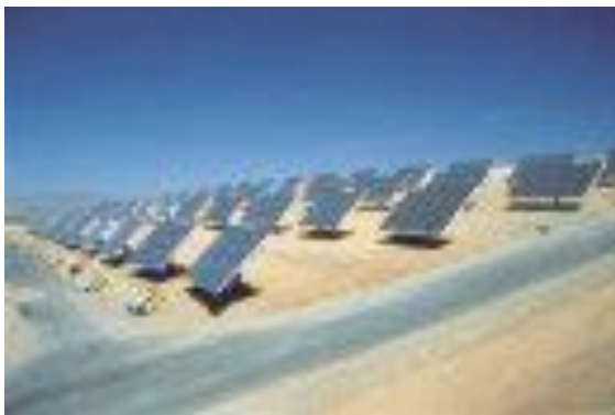
スペイン 1.2MW
